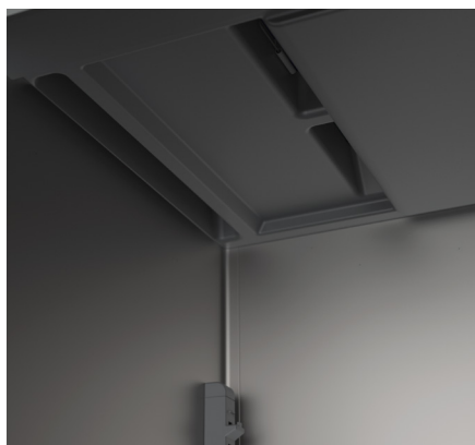
Canale aereazione | Ventilation duct
